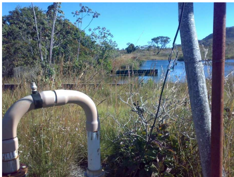
Figura 93 - Ponto de Captação no Córrego da Pontezinha (Coordenadas UTM - 225.807 E; 8.435.640 N; Zona: 23 L)
