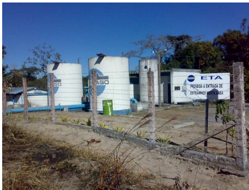
Figura 96 - Estação de Tratamento de Água - ETA (Coordenadas UTM - 225.912 E; 8.435.635 N; Zona: 23 L)
