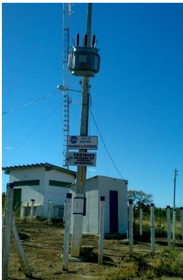
Figura 99 - Poço Artesiano utilizado para captação de água no município de Água Fria de Goiás (Coordenadas UTM – 201429 E; 8330679N; Zona 23L)
