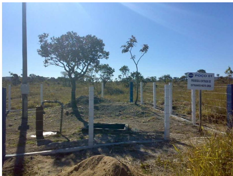
Figura 94 - Poço Artesiano 1 (Coordenadas UTM - 225824 E; 8435866 N; Zona: 23 L)
