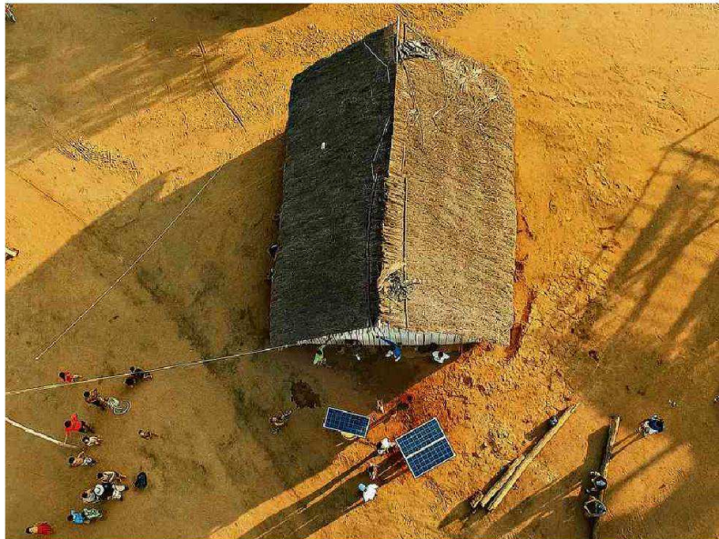
Instalação de placa de energia solar na Aldeia Piyulaga, no Parque Indígena do Xingu (MT) Todd Southgate
