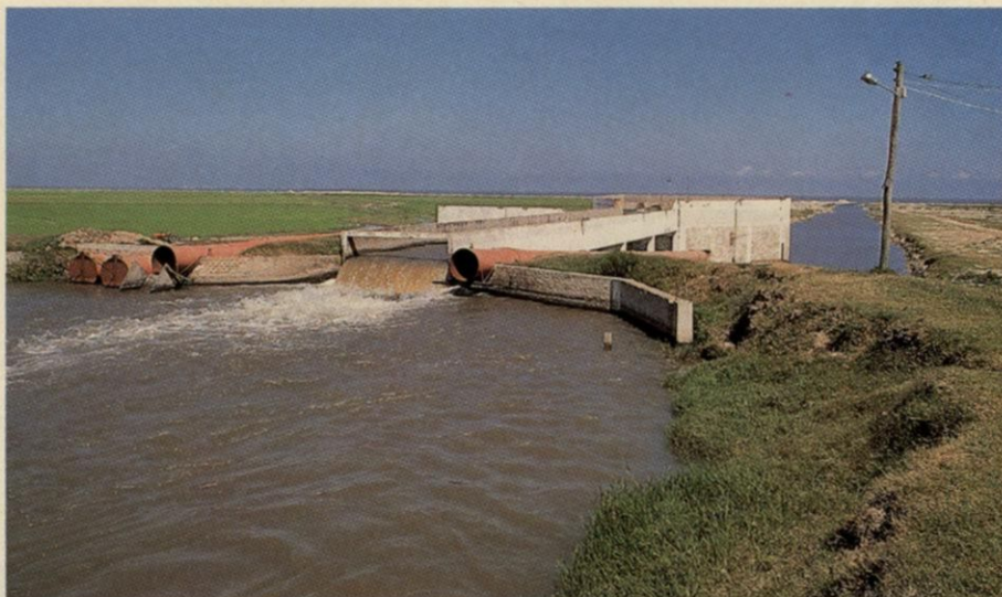
CAPTAÇÃO. Sistemas de bombeamento espalham-se à volta de toda a lagoa
