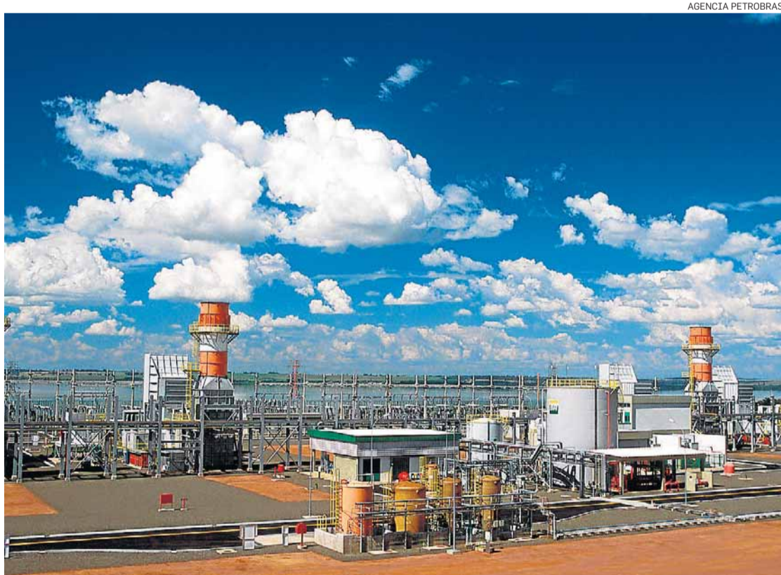
Expansão. Térmicas fornecem energia mais cara, mas são essenciais nos períodos de seca
