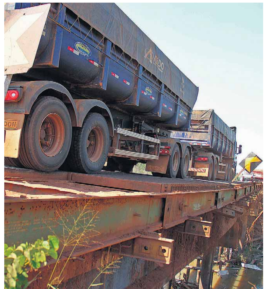
Ferrugem. Ponte na BR-158, na divisa entre Mato Grosso e Pará
