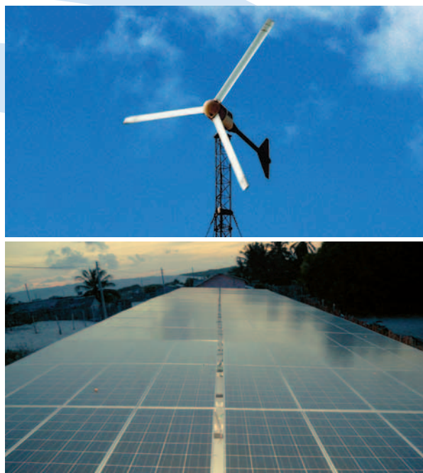
Gerador eólico e painel solar de 150 m 2
