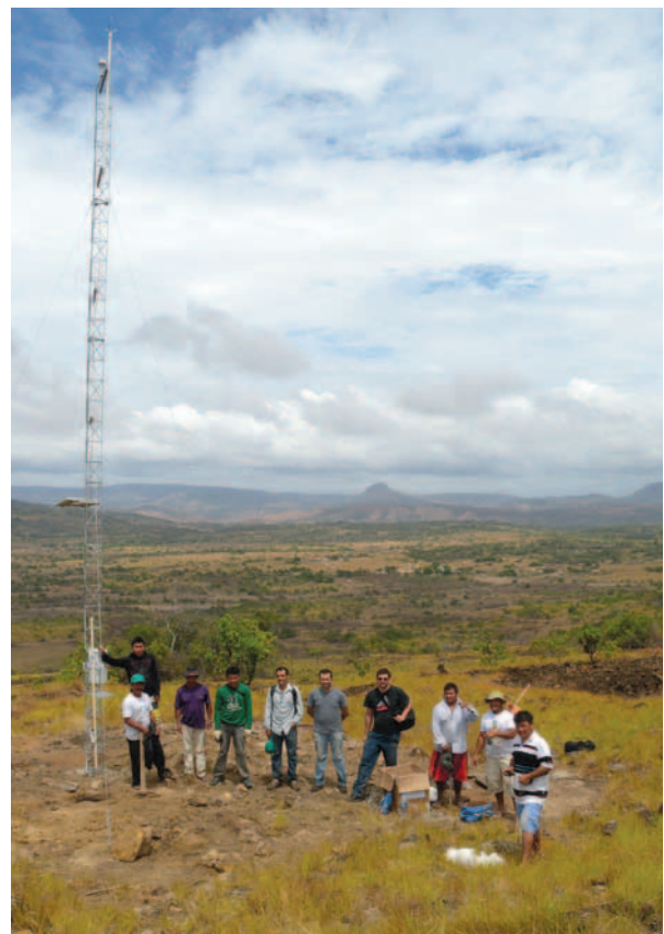
Equipes do CIR, ISA e UFMA durante a instalação da torre de medição na comunidade Pedra Branca
