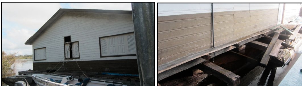
Figuras 4 e 9 - O prédio em processo de deterioração foi construído com recursos do Programa ARPA.
