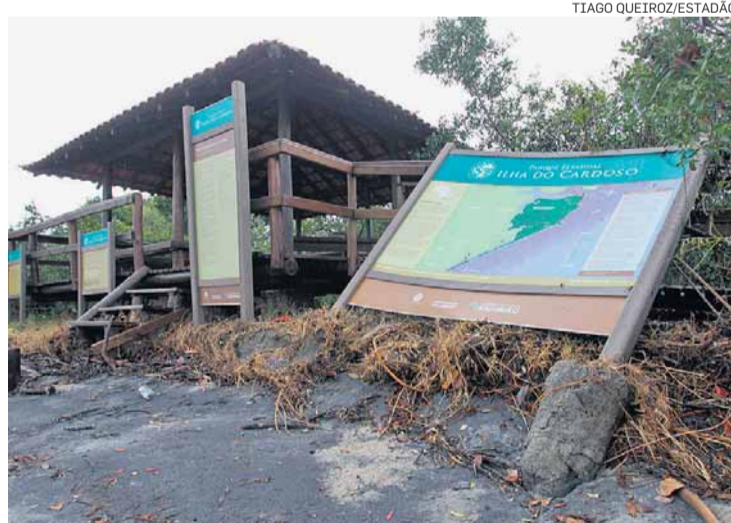
Recém-construído. Quiosque tem problema estrutural
