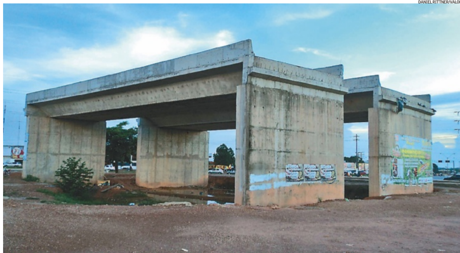
Estrutura central do Trevo do Roque, um dos viadutos inacabados em Porto Velho: retomada da obra espera pelo remanejamento de linhas de energia elétrica
