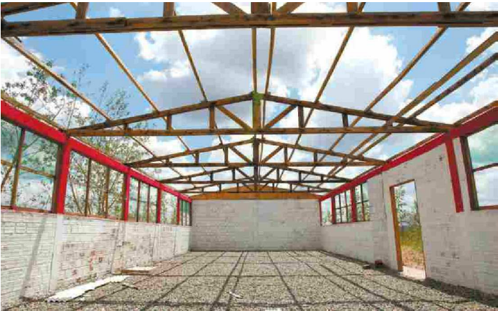
Galpão que antes servia de alojamento já não tem mais telhado, portas ou janelas
