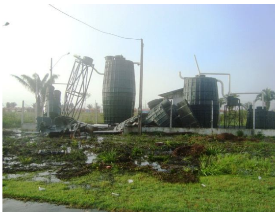
Foto – tanque de esgoto Mutum-Paraná
