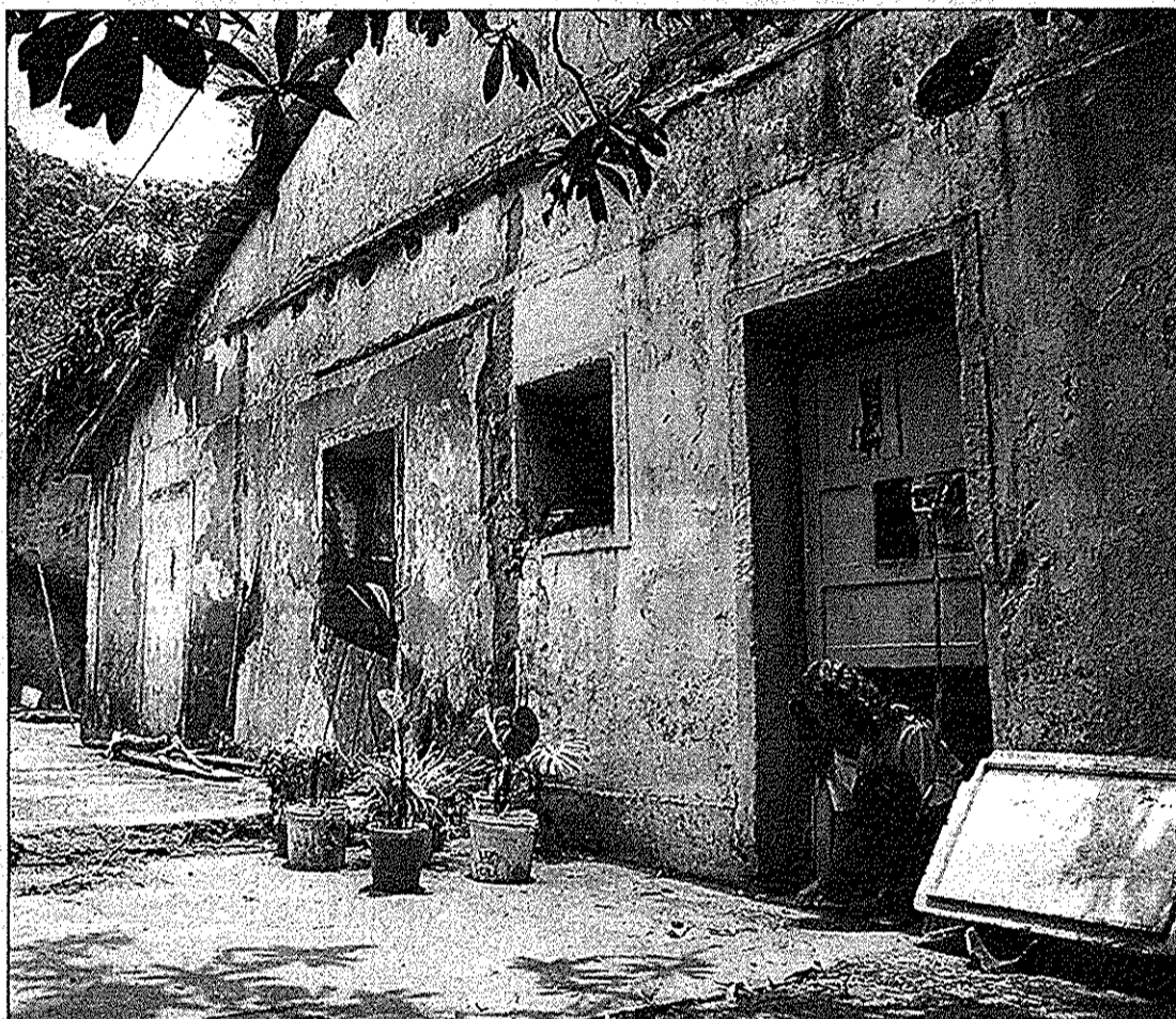
A CASA DE Luís Fernandes está desmoronando depois de passar por um incêndio e duas chuvas fortes
