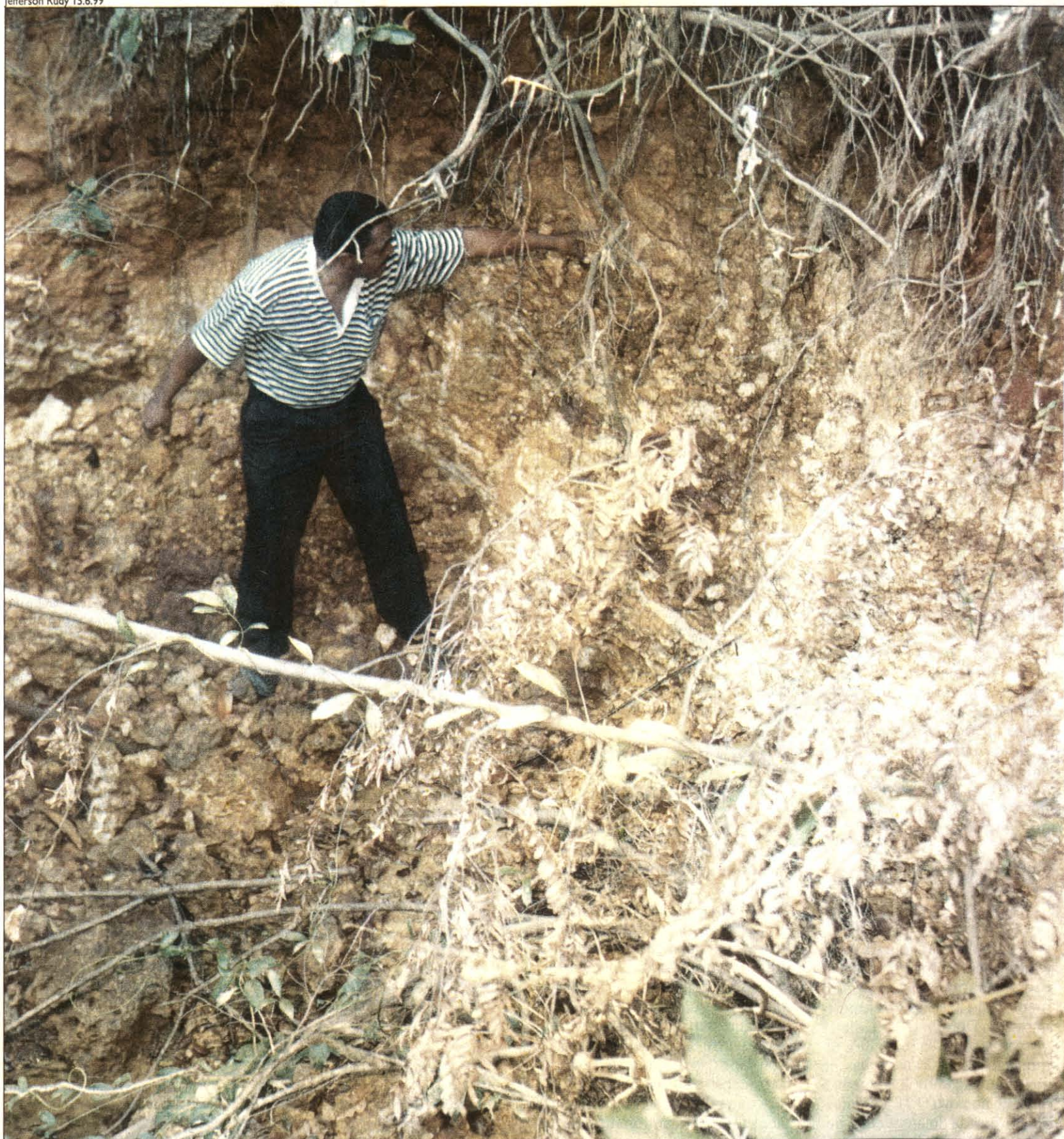
Buracos enormes produzidos pelas águas que vêm das ruas expõem as raízes de árvores como a copaíba, que dá nome ao parque, e destroem o solo
