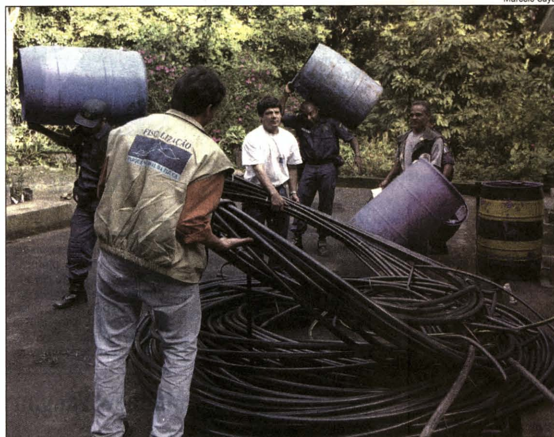
AS MANGUEIRAS APREENHIDAS: captação clandestina com o desvio de água de nascentes na Floresta da Tijuca
