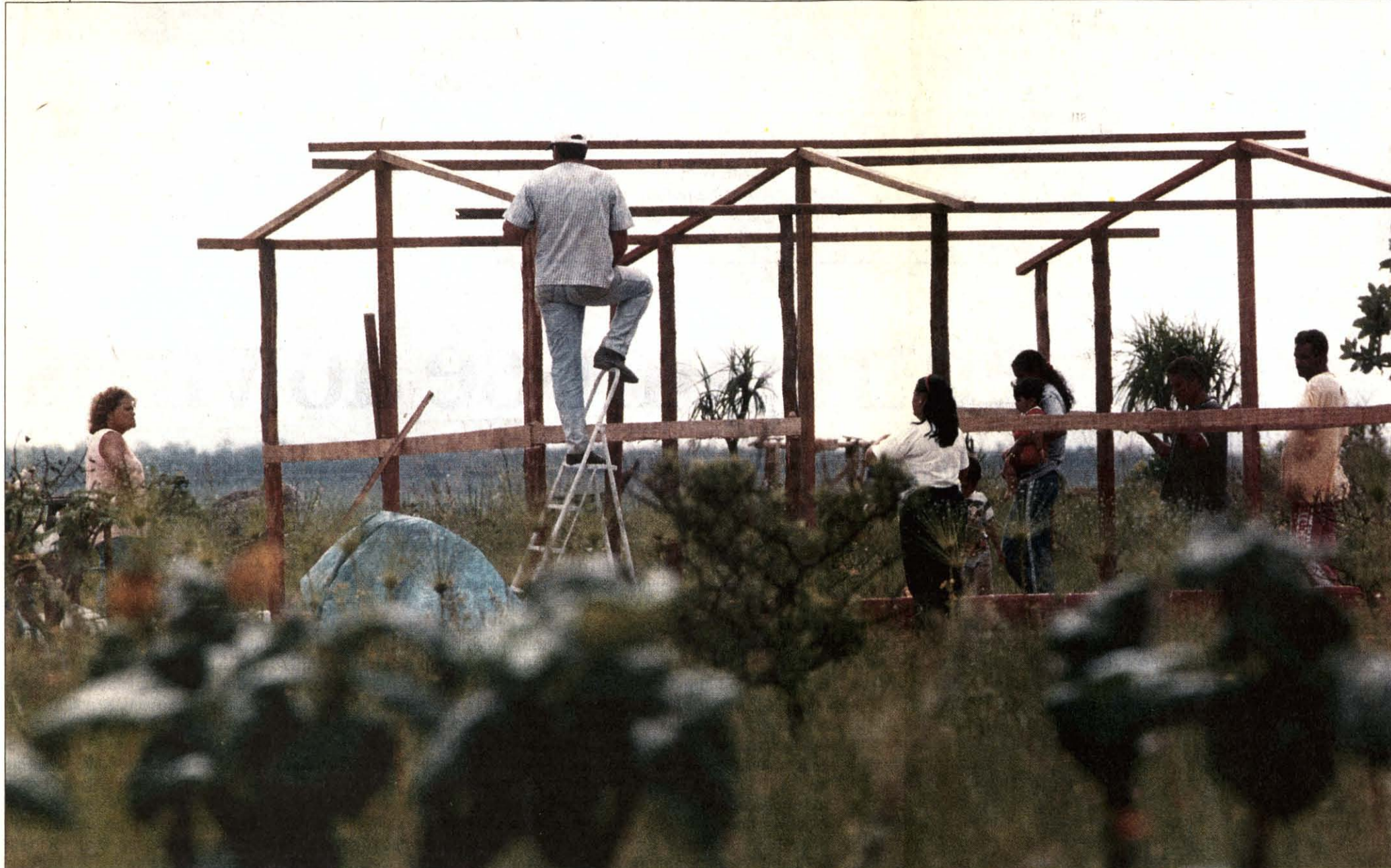
Mais uma estrutura em madeira de uma casa ergue-se irregularmente entre o Riacho Fundo e o Núcleo Bandeirante. Alguns foram notificados em 12 de janeiro, mas não arredaram pé
