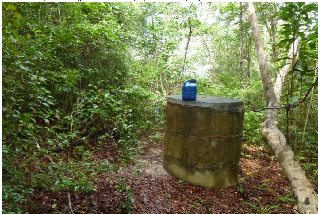
Figura 39. Estrutura de concreto associada à tubulação para transporte de esgoto. O transporte é feito desde o distrito de Pipa até a lagoa de estabilização, cortando a porção norte do PEMP, Tibau do Sul-RN.
