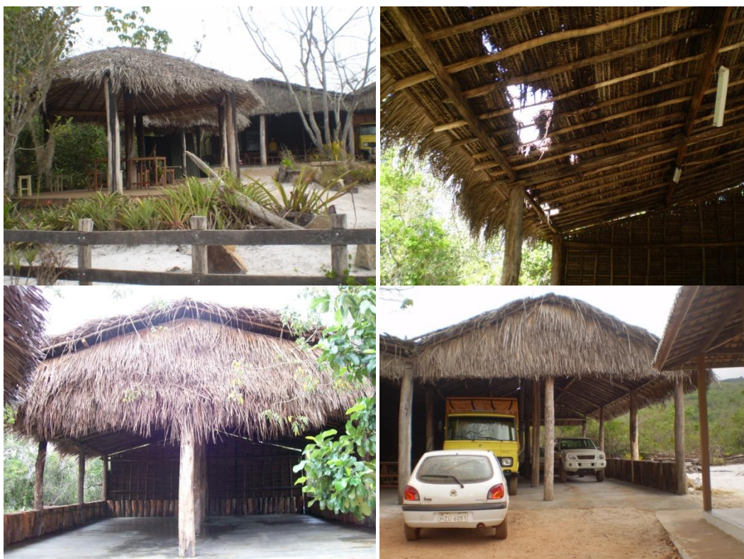
Figura 25: Parte do Complexo da Sede Administrativa, em sentido anti-horário, a partir da esquerda: Quiosques, com o Barracão ao fundo; Barracão; Garagem; Detalhe do telhado de palha precisando de reforma.
