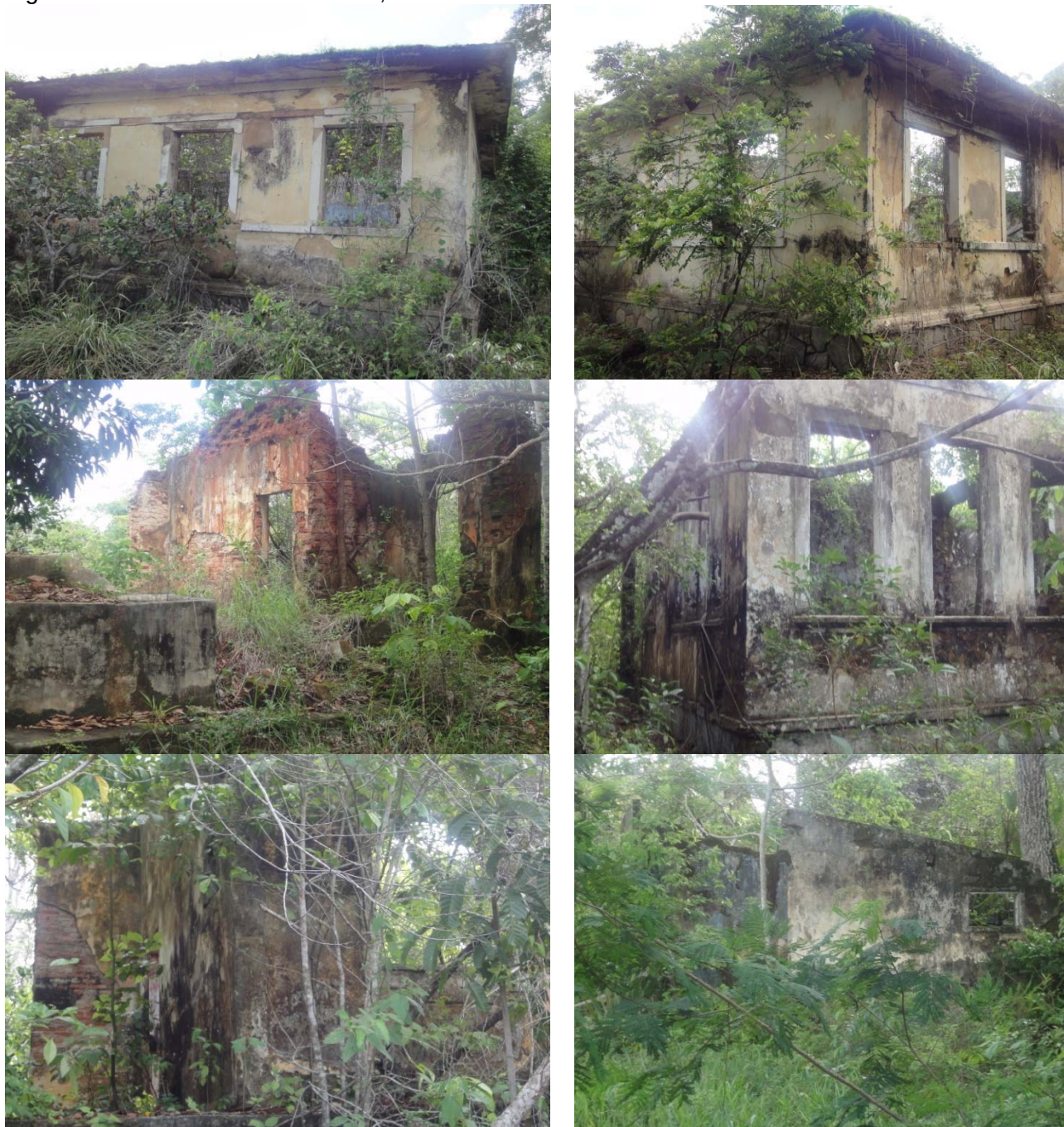
Figura 41: Infraestrutura em ruínas, Sítio do Patrimônio do Ibura.
